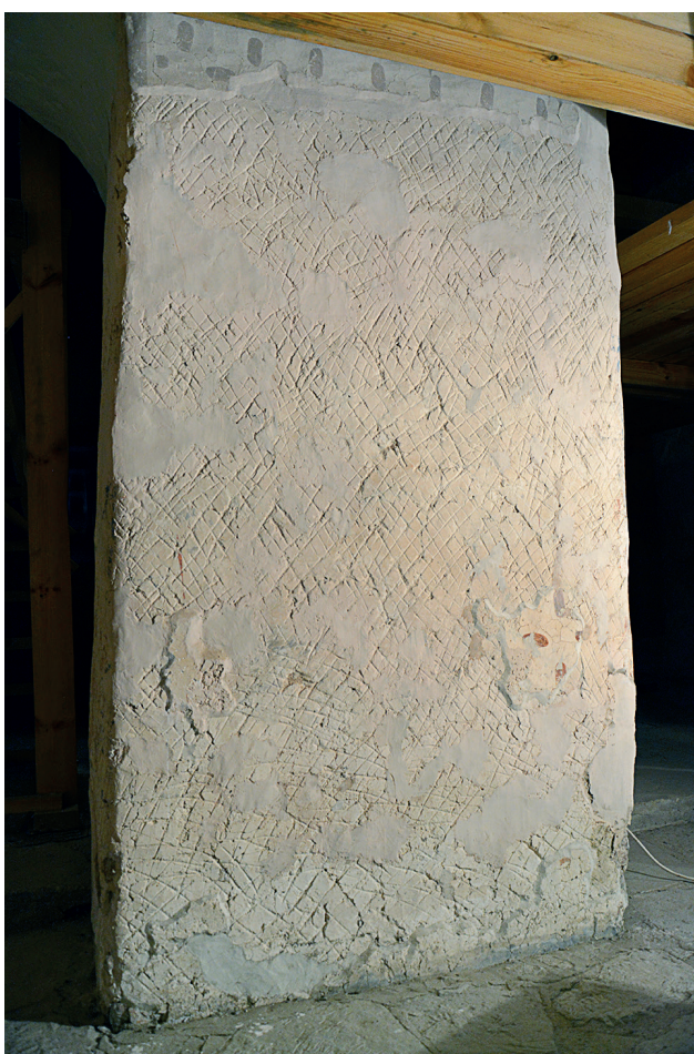
Ил. 12. Северо-восточный столб. Западная грань. До снятия плит пола Fig. 12. North-eastern pillar. Western edge. Before the removal of the floor slabs
