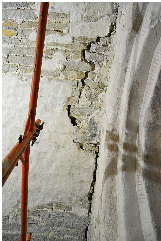
Ил. 10. Западный притвор. Сквозная трещина в кладке в месте примыкания притвора к четверику храма Fig. 10. Western narthex. A through crack in the masonry at the junction of the narthex to the quadrangle of the church
