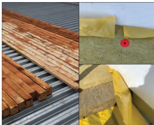
Рис. 2. Ряд нарушений при выполнении кровельных работ
