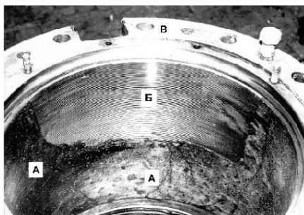
Рис. 1 – Повреждения втулки подшипника направляющего аппарата (А – стеклоэпоксидная втулка, Б – стальная обойма втулки, В – корпус подшипника)
