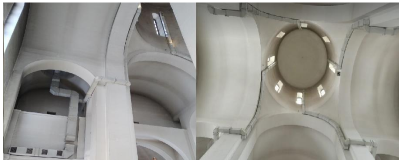
Рисунок 1 – Воздуховоды системы вентиляции
