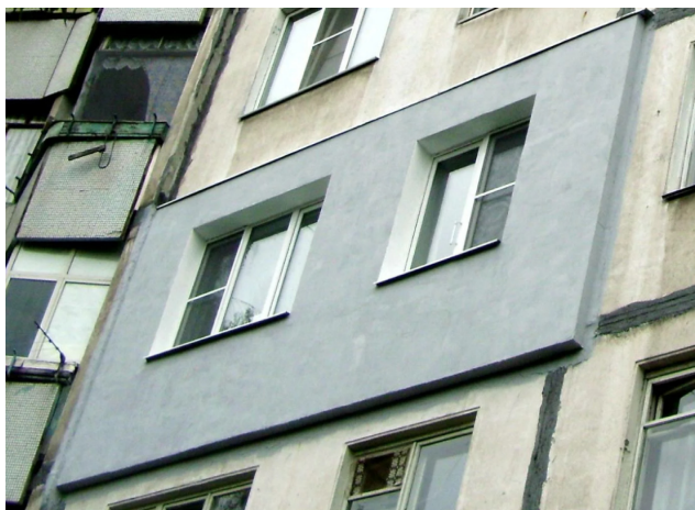
Рис.1. утепление панели, потерявшей теплоизоляционные свойства.
