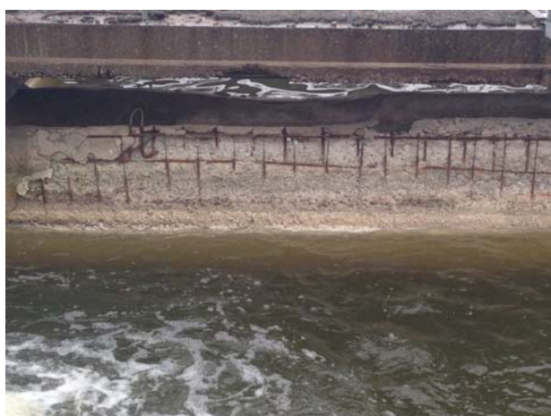
Рис.2. Состояние железобетонных конструкций аэратора-усреднителя после длительного воздействия щелочных и кислых сточных вод
