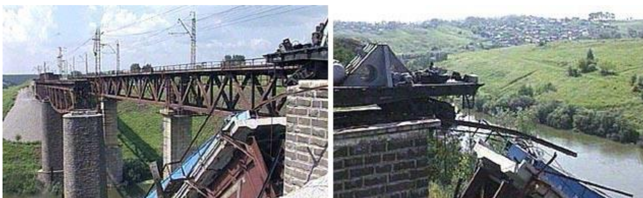
Рис. 1. Последствия обрушения моста через р. Пышма
