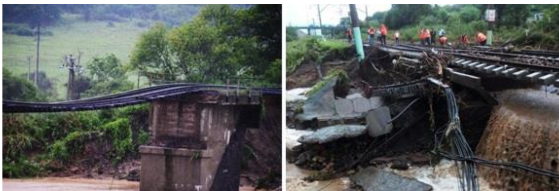
Рис. 7. Мосты, разрушенные на Дальневосточной железной дороге
