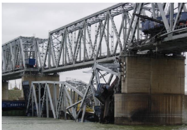
Рис. 4. Разрушение пролётного строения моста через р. Иртыш у Омска
