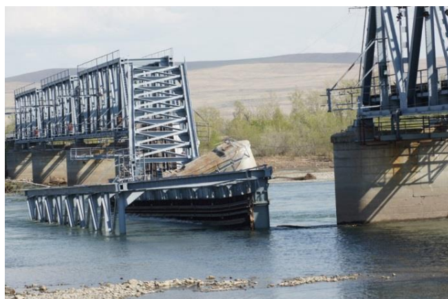
Рис. 5. Частичное разрушение моста через р. Абакан
