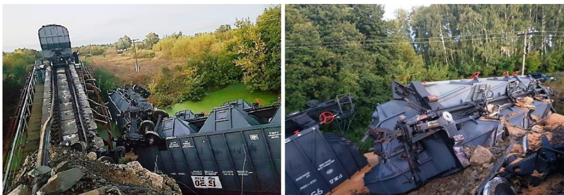
Рис. 6. Разрушение моста через реку Берёзовка
