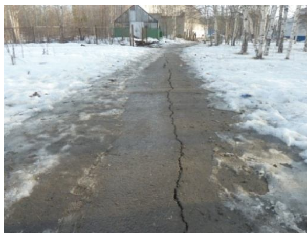
Рис. 2. Развитие морозобойных трещин в 7 микрорайоне (апрель 2012)
