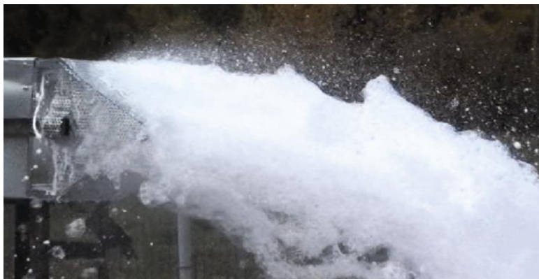
Рис. 2. Фрагмент работы генератора пены высокой кратности со спиральным насадком
