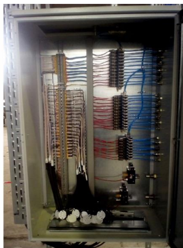
Пневматический шкаф управления запорной арматурой и насосами
