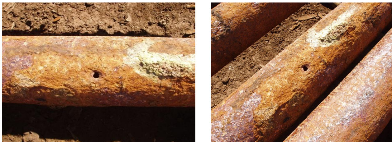
Рис. 1.9. Сквозная наружная коррозия обсадных труб
