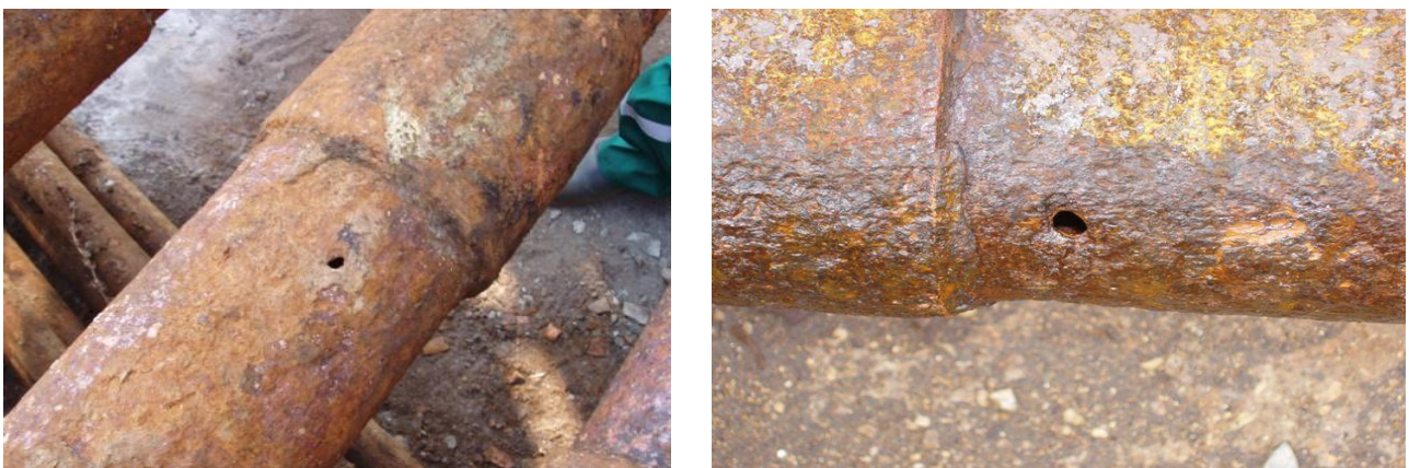
Рис. 1.7. Сквозное отверстие возле муфты плюс наружная коррозия
