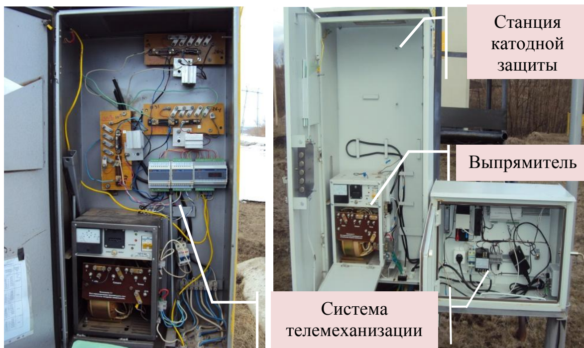
Рис. 6.1. Станции катодной защиты НГДУ «Лениногорскнефть» с расположением системы телемеханизации внутри СКЗ (слева) и в отдельном шкафу (справа)
