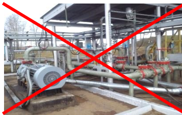
Рис. 4 - Насосная откачки нефти
