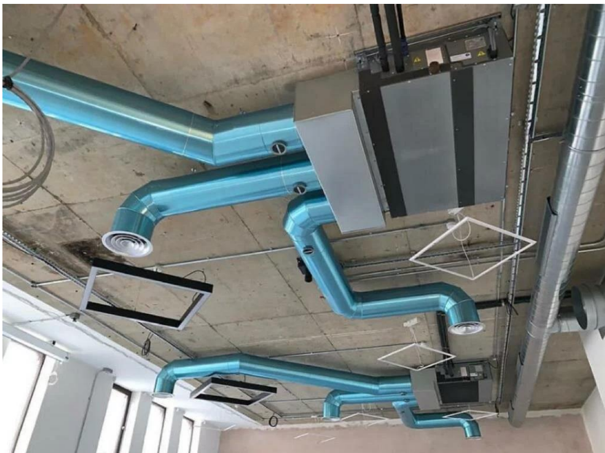
Рис. 9. Вид внутреннего блока и воздуховодов системы кондиционирования канального типа (источник: [9])
