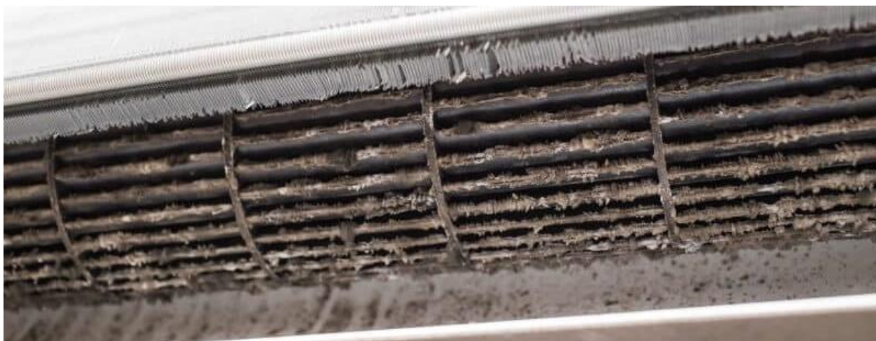
Рис. 8. Плесень и грязь, образовавшаяся на воздушном вентиляторе внутреннего блока системы кондиционирования типа «настенная сплит-система» (источник: [8])
