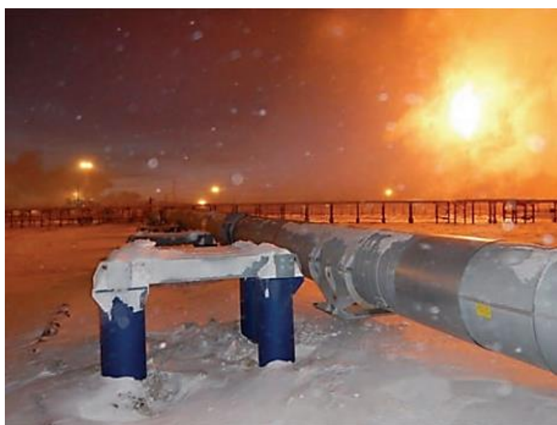
Рис. 7 – Сход трубопровода с опор
