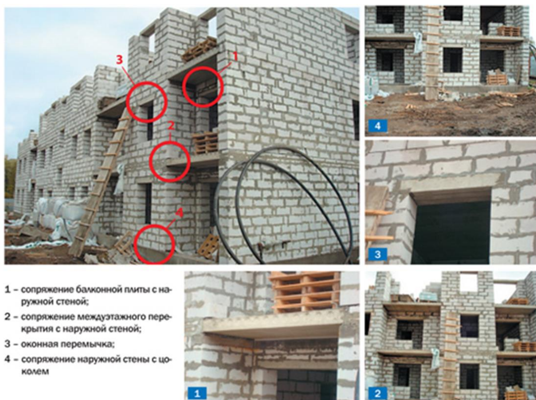
Рис. 2. Теплопроводные включения в оболочке строящегося жилого дома
