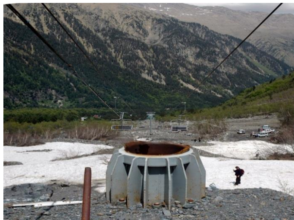
Фото 2. Срезанная лавиной опора канатно-кресельной дороги в Цейском ущелье
