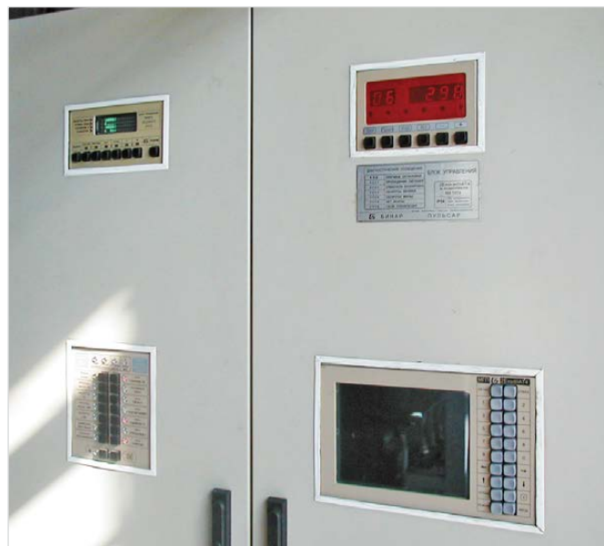
Рис. 2 — Система САУ ГМК «ДЕКАДА» в цехе газомотокомпрессоров СПХГ Прибужская
