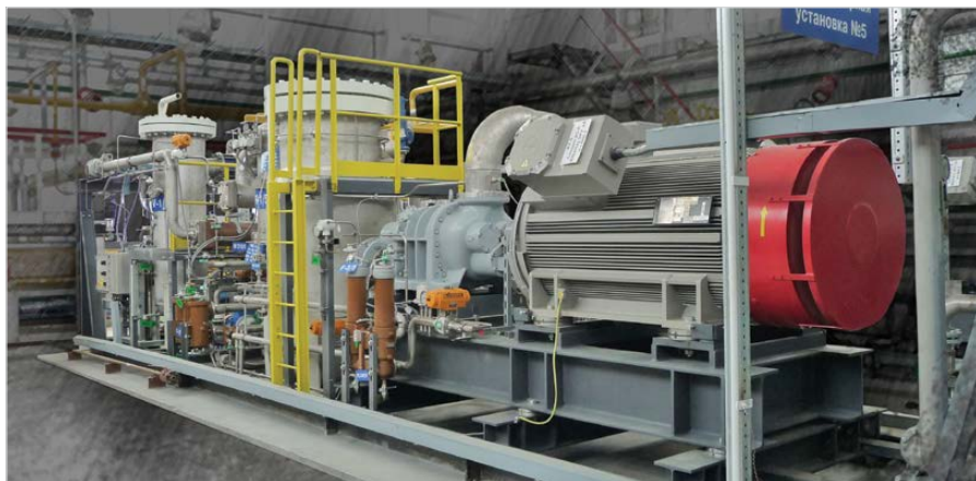
Фото 1. Компрессорная установка в ангарном (цеховом) исполнении
