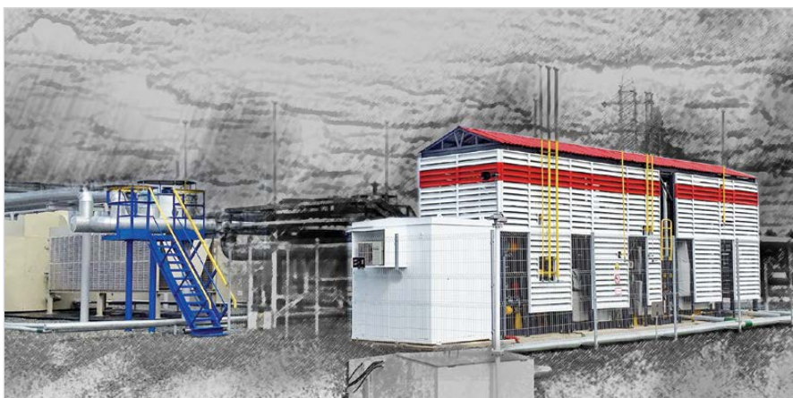
Фото 9. Блок подготовки попутного газа для ГТУ-ТЭЦ Усинского месторождения
