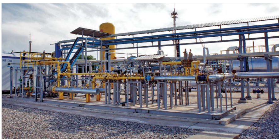
Фото 10. Система подготовки топливного и пускового газа для газоперекачивающих агрегатов ДЭС «Алан»
