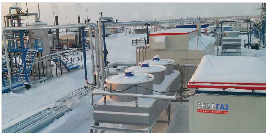
Фото 11. Комплекс оборудования для подготовки попутного газа на ЦПС Западно-Могутлорского месторождения
