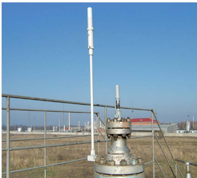
Рис. 1 — Фото установленных на скважине беспроводных датчиков и модуля передачи данных
