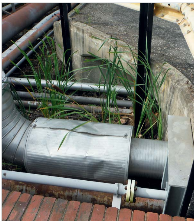
Рис. 1 — Внешний вид трубопровода Овертон-роуд до реконструкции
