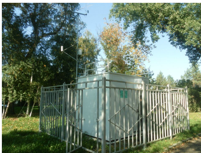
Рис. 2. Станция автоматического контроля загрязнения атмосферного воздуха (МР-28)
