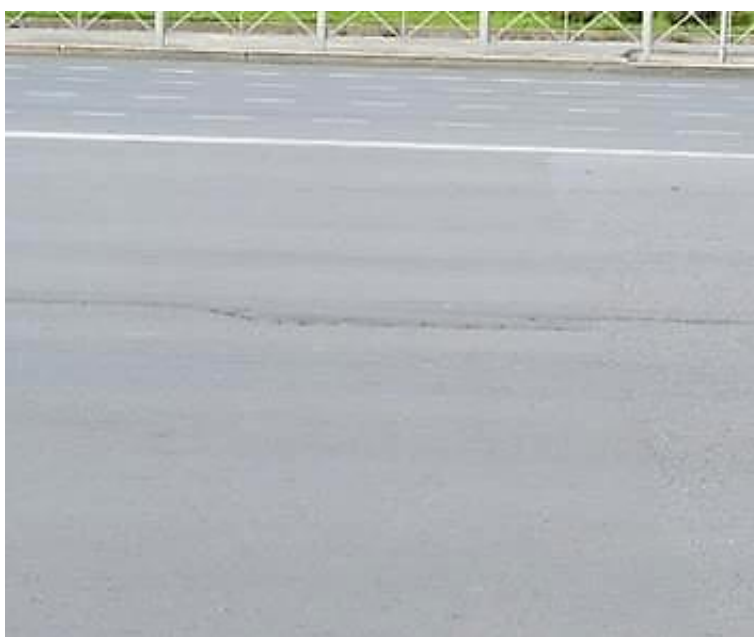
Рис. 2. Разрушение покрытия проезжей части в районе продольного деформационного шва
