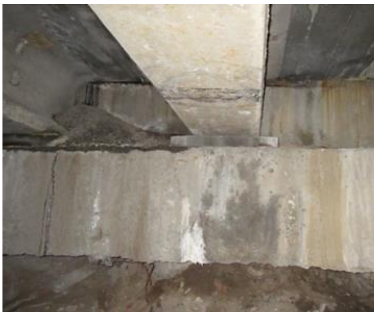
Рис. 1. Замачивание и загрязнение ригеля и мостового сооружения
