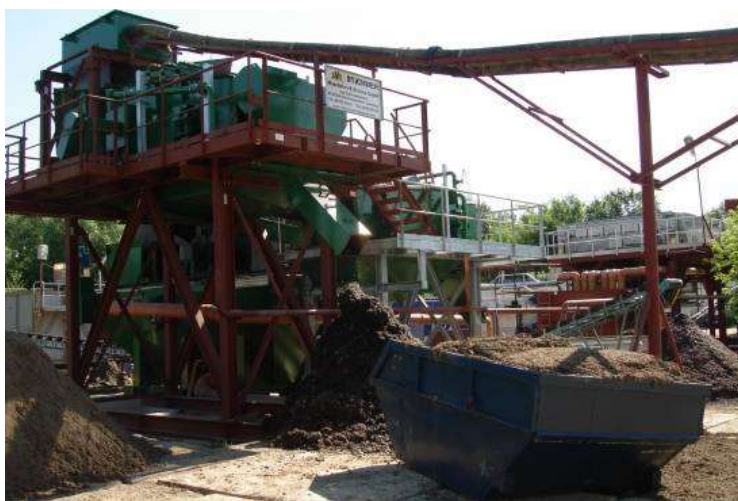
Рис. 19. Мобильный завод по обезвоживанию иловых отложений, (комплекс ленточных фильтр-прессов)
