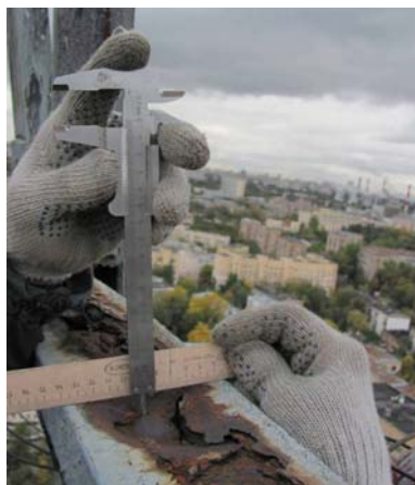
Рис. 2. Выпучивание стенки швеллера щелевой коррозией
