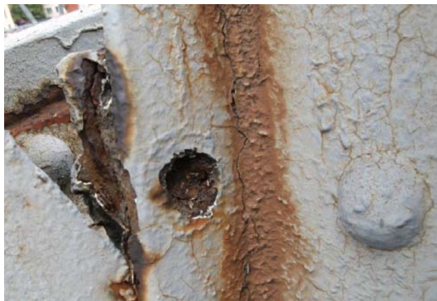
Рис. 4. Отрыв головки заклёпки продуктами коррозии
