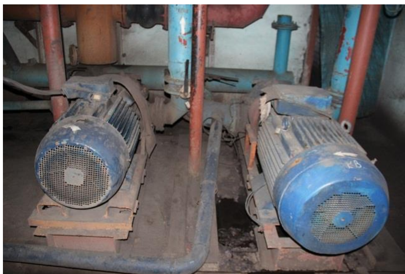
Рис. 2. Сетевой насос Д – 315, с асинхронным электродвигателем мощностью 55 кВт
