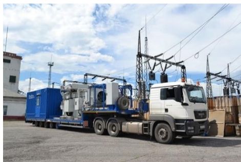
Рисунок 3 – ММПС 110/10(6) кВ мощностью 25 МВА завода «ПитерЭнергоМаш»
