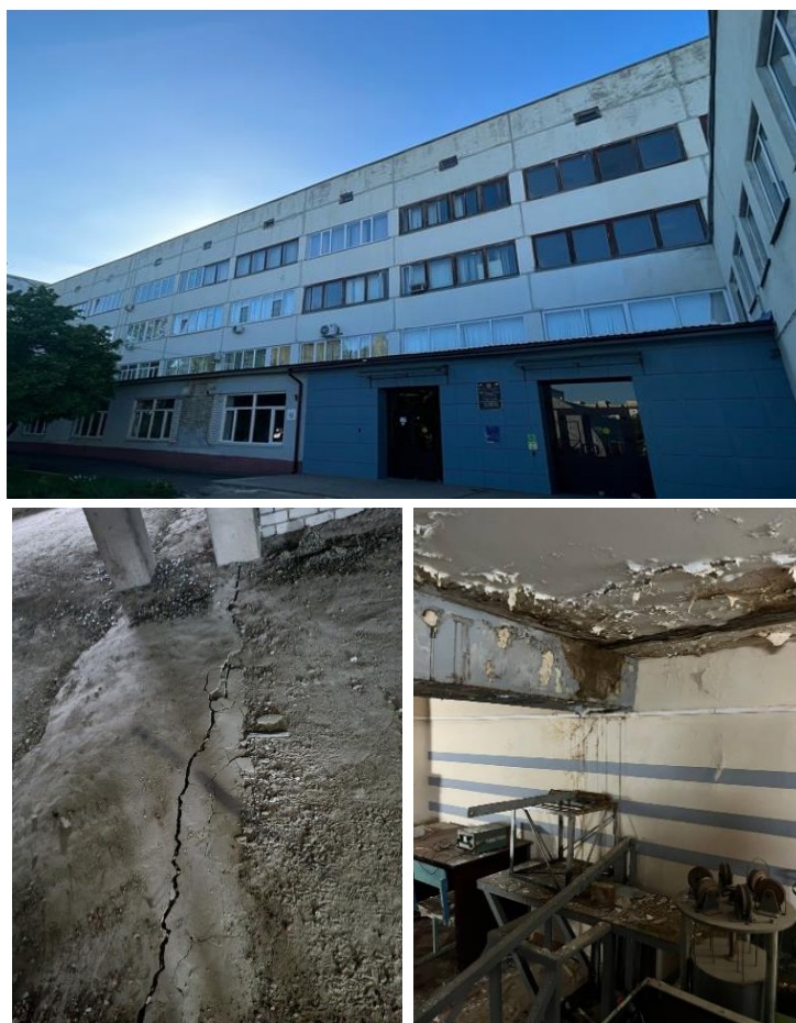
Рис. 1. Вид корпуса «Д» ТГТУ с участками наибольших повреждений
