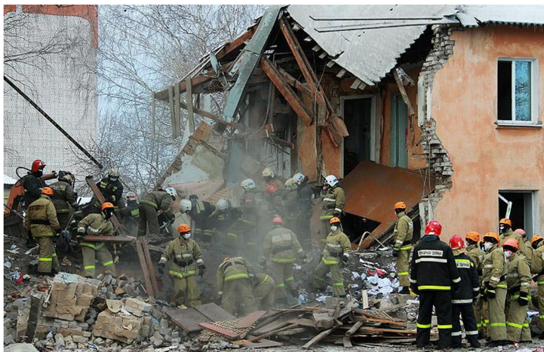
Рис. 2. Работы на месте взрыва бытового газа в г. Иваново
